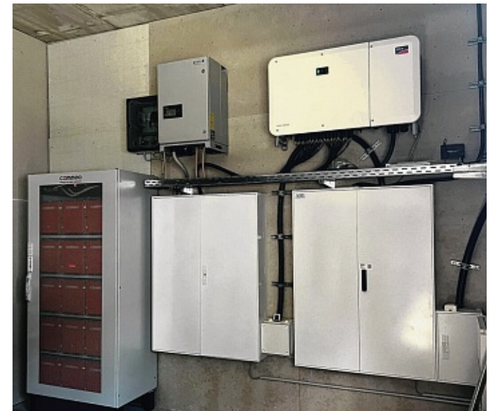
Die „Energiezentrale“ von WohnArt: In einem extra Raum sind alle Steuerungselemente verbaut – für Pumpe, Speicher und Kollektoren.
